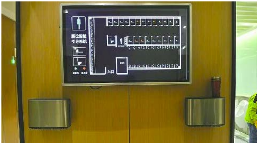
Abbildung 6.2-2: „Vacancy-guidance-system“ am Eingang der Toiletten
